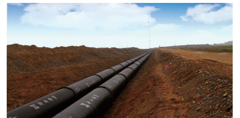
离心球墨铸铁管应用于河南省洛阳市故县水库引水工程
